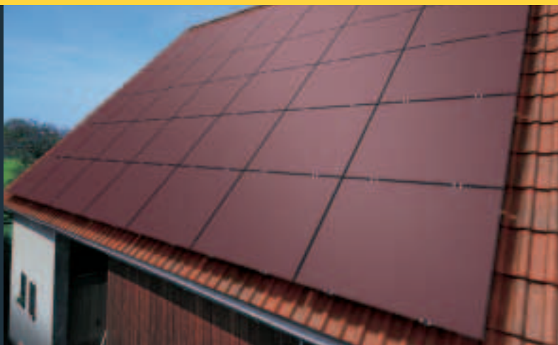
Impianto sopra tetto con moduli MPE della serie AL
